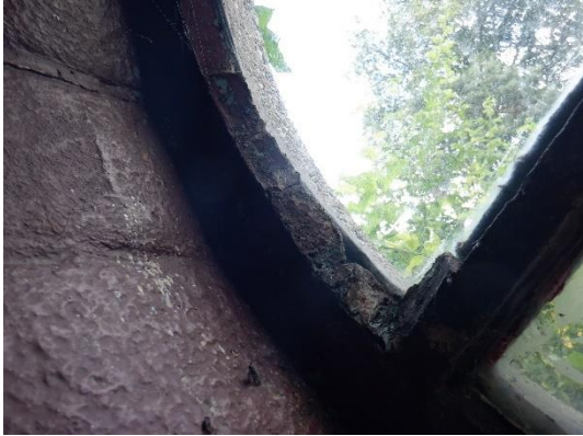
Foto oude, verdachte raamafwerking raam achtergevel
