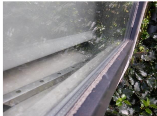
Foto niet verdachte raamafwerking
